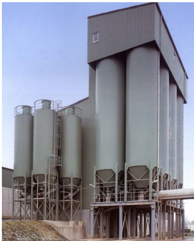
Obr. 41 Pohľad na zostavu zásobníkov. V spodnej časti sú kužeľové dna a pod nimi dopravníky pre vyprázdňovanie.
